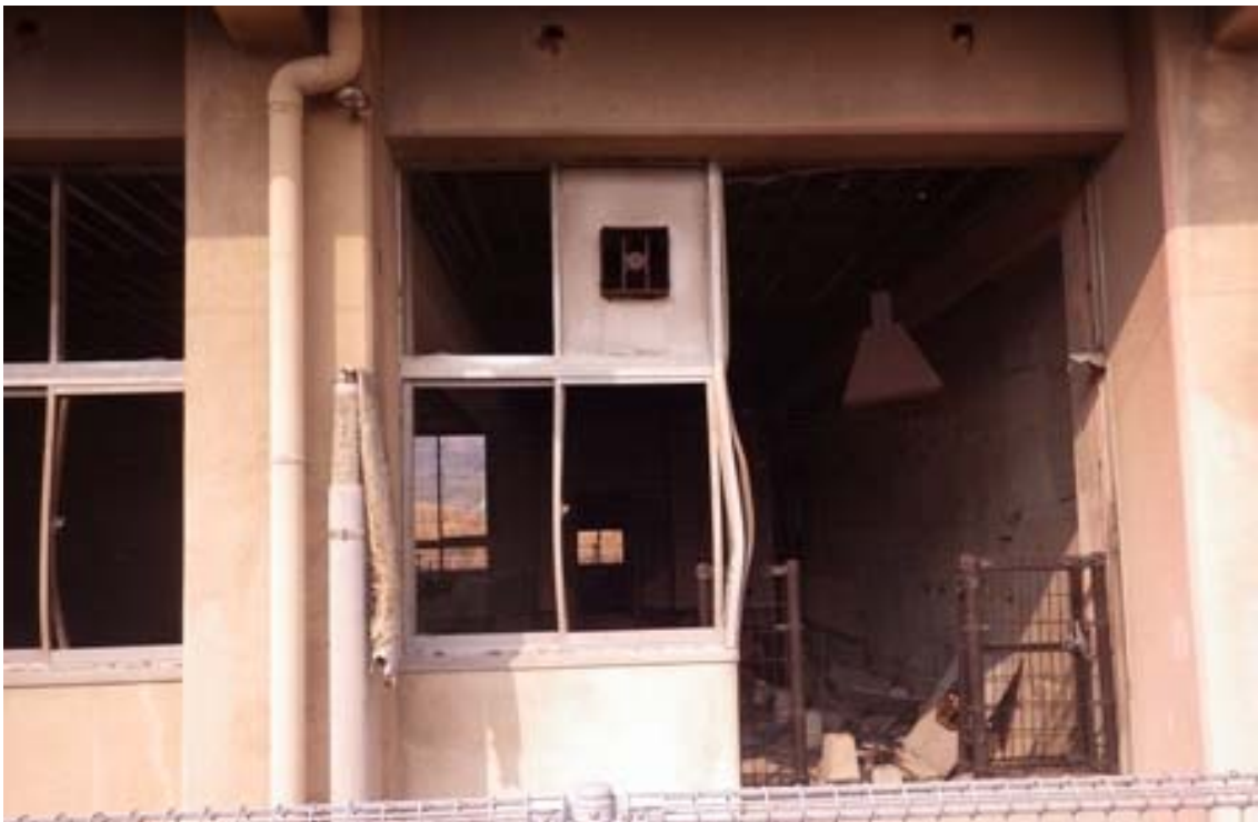
火砕流による被害 自然の力のすごさを実感します
